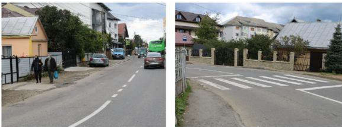
Figura 2.5.54 Trotuare în stare necorespunzătoare (exemplificare)
