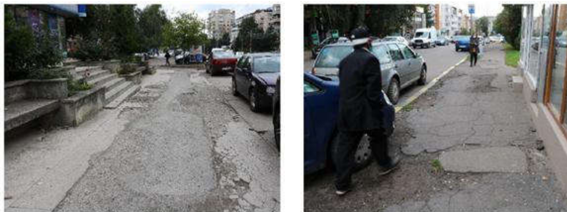
Figura 2.5.51 Trotuare în stare necorespunzătoare (exemplificare)
