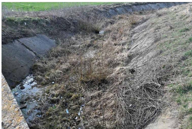
Figura nr. 3-8 Corpul de apă Dragomirna (lac Dragomirna – cf Suceava) în zona de intersecție cu proiectul
