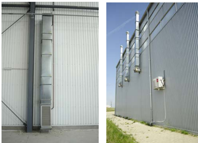
Fig.3. Sistemul de ventilației al stației de sortare (interior și exterior)
