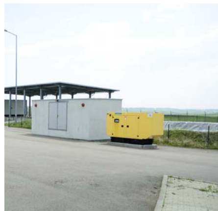
Fig.21. Stația de pompare și generatorul electric
