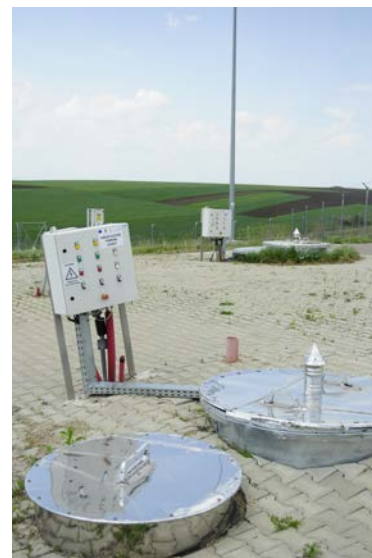
Fig.24. Stația pompare levigat
