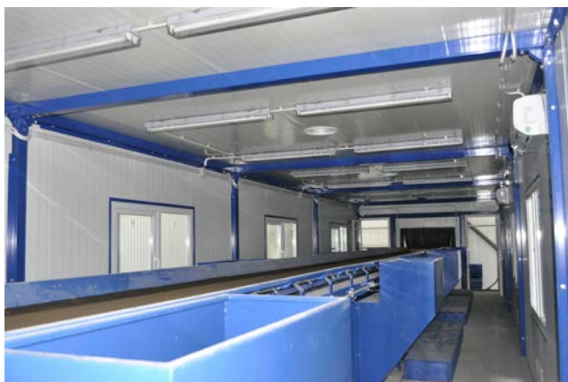
Fig.12. Interior cabina de sortare
