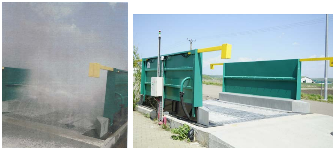
Fig.19. Instalația de spălare roți
