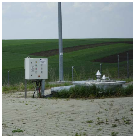
Fig.25. Stația de pompare condens
